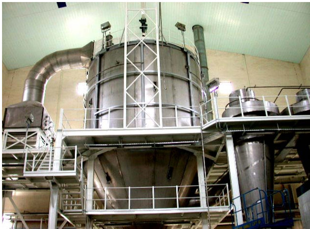
نمایی از کارخانه شیر خشک نصب شده در اصفهان و مشهد
